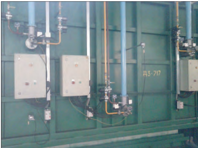
Рис. 5. Автоматические горелки печи Fig. 5. Automatic furnace burners
